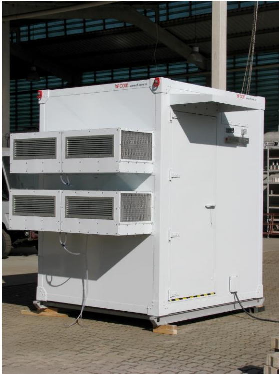
Shelter de Telecomunicações, Plataforma Offshore Petrobrás P25
