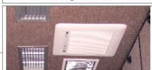
Módulo Interno e Grelhas de Retorno Montagem com Duto
