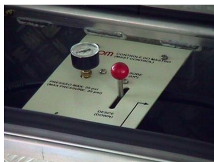
Detalhe do painel com o sistema instalado
